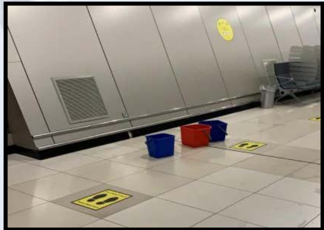
صورة 22: تسرب مياه الأمطار داخل مبنى الركاب T1
