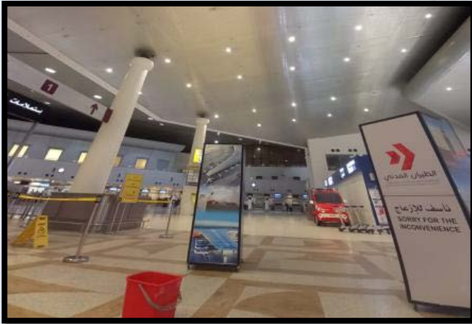
صورة 23: تسرب مياه الأمطار داخل مبنى الركاب T1
